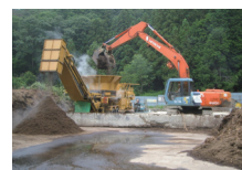
(5) 設備稼働状況(破碎)
