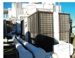
冷凍機室外機
