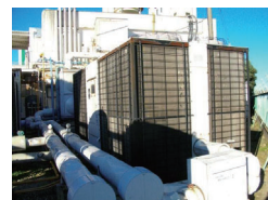
冷凍機室外機
