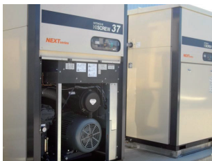
コンプレッサー
